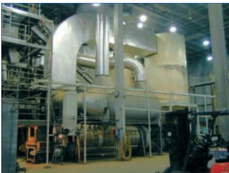
Unité de séchage de boues
